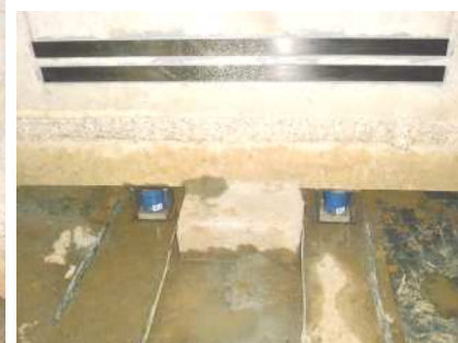
Vérins sous les voiles en files 1 et sous les consoles bridées aux massifs en file 2.
